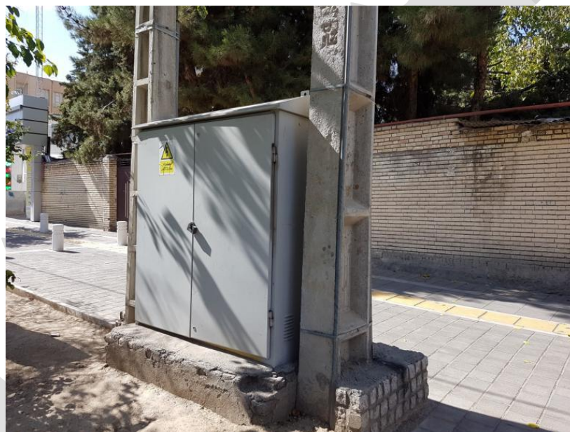
شکل ۹- تصویر تابلو توزیع زمینی
